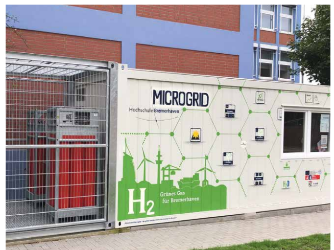
Microgrid-Container der Hochschule Bremerhaven
